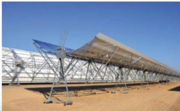
ЮАР: CSP – Solar 100MW
